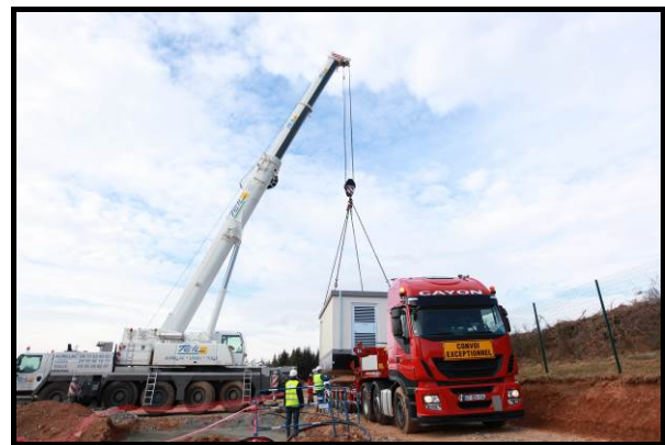
Installation d'un Poste de Conversion sur la centrale solaire photovoltaïque de La Forêt © La Compagnie du Vent
