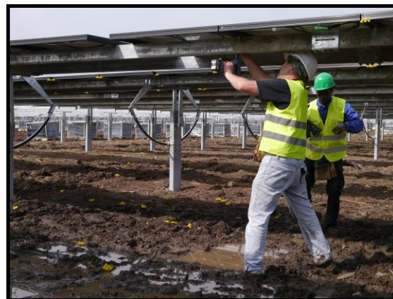
Pose des panneaux photovoltaïques sur la centrale de Roc du Douin © Photovideodrone
