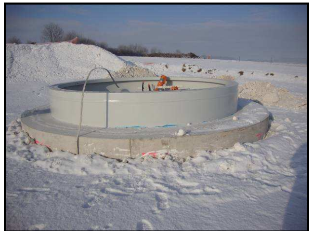
Partie supérieure d'une fondation sur laquelle sera fixée la tour d'une éolienne du parc éolien du Miroir
