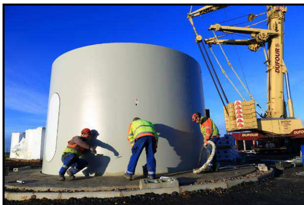
Montage de la première partie de la tour d'une éolienne d'un parc éolien de la Compagnie du Vent
