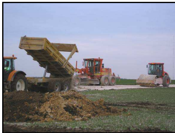
Création d'une piste d'accès d'un parc éolien de La Compagnie du Vent
