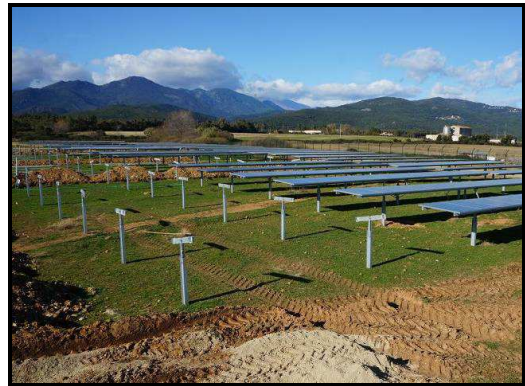
Montage des panneaux photovoltaïques d'une centrale de La Compagnie du Vent (Porette de Néronne – Corse)
