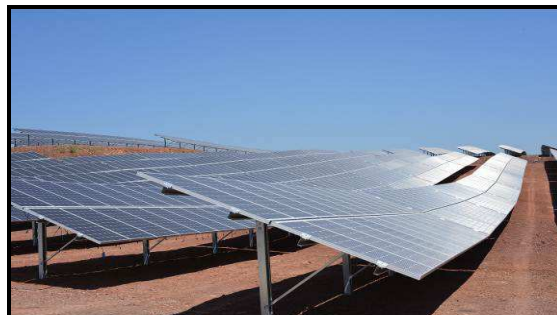
Vue partielle de la centrale solaire de Le Bosc et Soumont © Aérimage/Rémi Grosset
