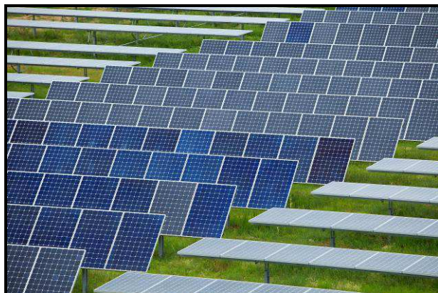
Centrale photovoltaïque au sol de Porette de Néron (Corse) avec panneaux solaires sur trackers © GDF SUEZ/Camille Moirenc
