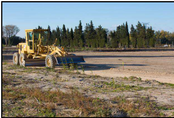
Terrassement d'un site de La Compagnie du Vent (Les Iscles – Bouches- du- Rhône)
