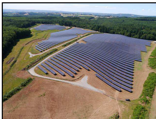
Centrale solaire photovoltaïque de La Forêt © Photovidéodrone/La Compagnie du Vent
