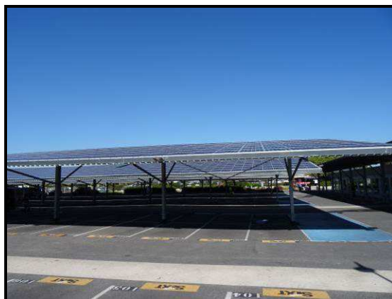
Ombrières solaires photovoltaïques sur le parking des loueurs de l'aéroport de Montpellier Méditerranée
