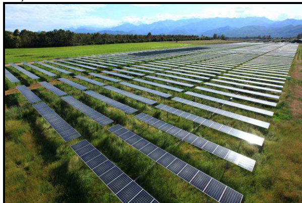
Centrale solaire photovoltaïque de Porette de Nérone (Haute-Corse). © GDF SUEZ Camille Moirenc
