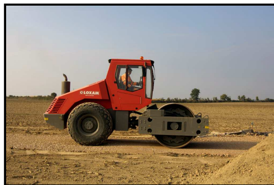
Création d'une piste d'accès d'un parc éolien de La Compagnie du Vent
